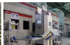
プラズマ溶射設備
